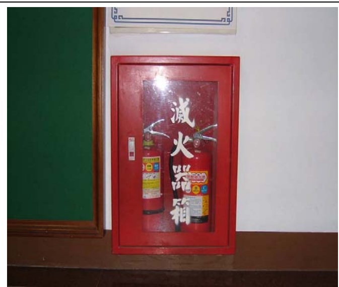
安全及消防設備
